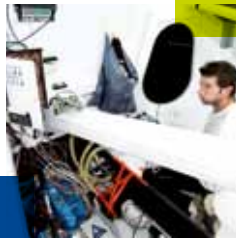
Installation de l'électronique embarquée
